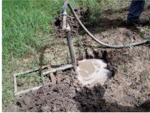
Figura 6: Bomba (inyección de lodos). Fuente: UNICEF en colaboración con CRS (Catholic Relief Services) y Martínez, B.A.
